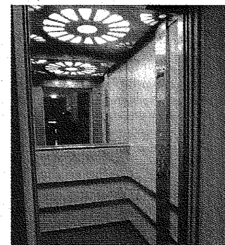
Ogromne znaczenie dla bezpieczeństwa mieszkańców ma zamontowany w kabinie windy system głośnomówiący, system łączności awaryjnej dla służb ratowniczych oraz czytniki dostępu w kasetach wezwań
