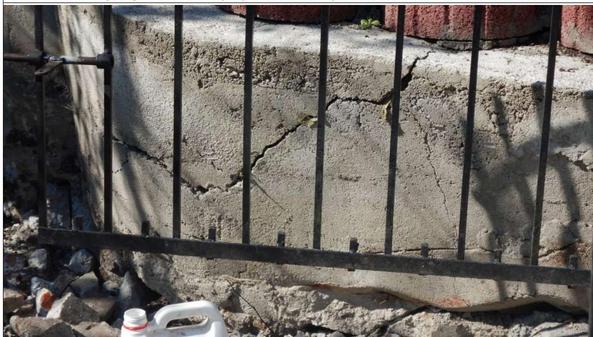
Uszkodzony betonowy murek w obrębie posesji (maj, 2023)
