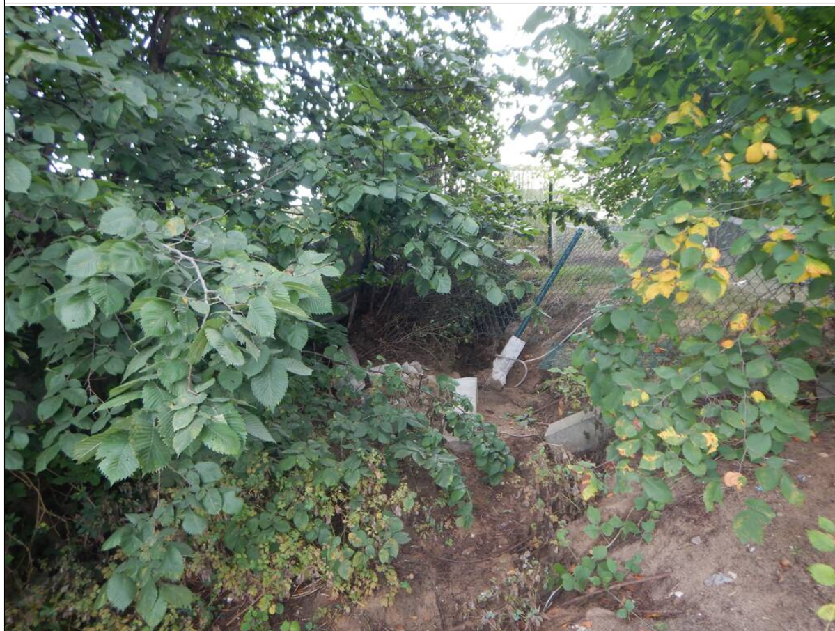
Fot. 2 Uszkodzone ogrodzenie, ul. Toruńska 85 (Mianowski, 2022)
