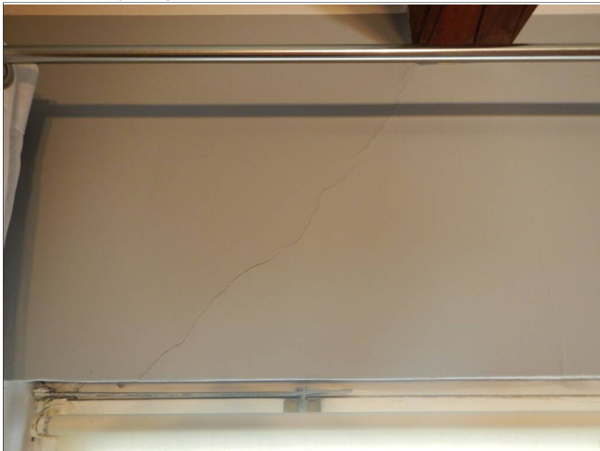
Fot. 9 Skośne spękanie nad ramą okna w mieszkaniu, ul. Wiśniowa 6 (Mianowski, 2022)
