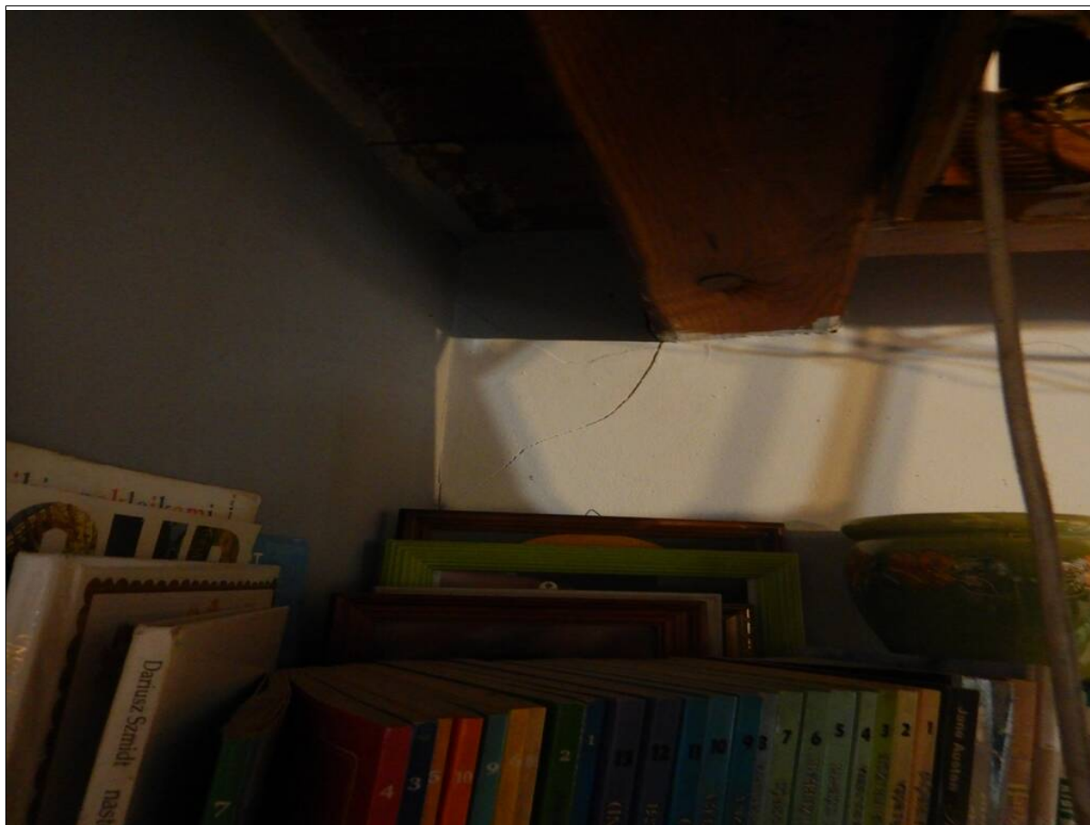
Fot. 10 Spękania na ścianie w mieszkaniu, ul. Wiśniowa 6 (Mianowski, 2022)
