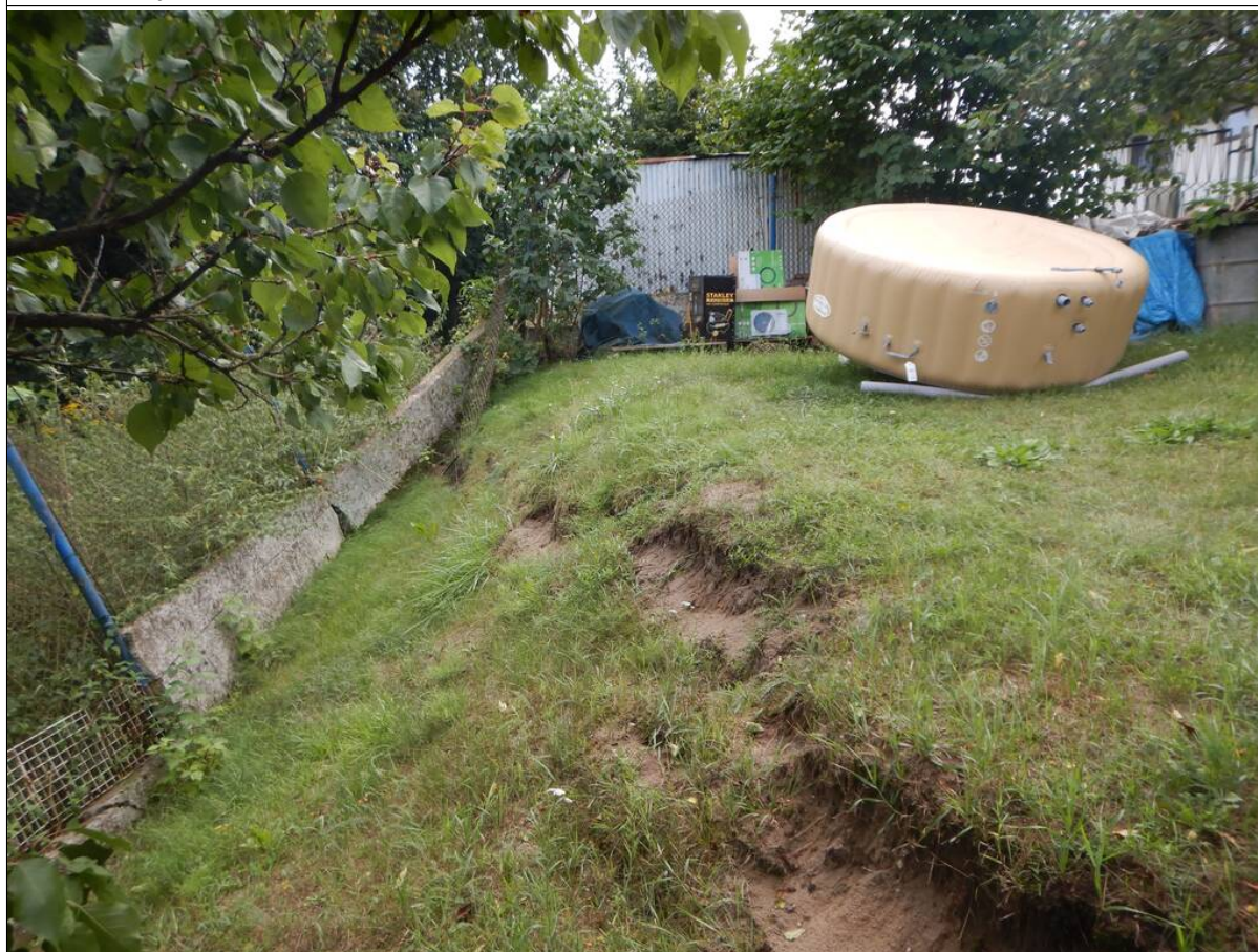
Fot. 1 Uszkodzone ogrodzenia oraz skarpa główna, ul. Wiśniowej 6 (Mianowski, 2022)
