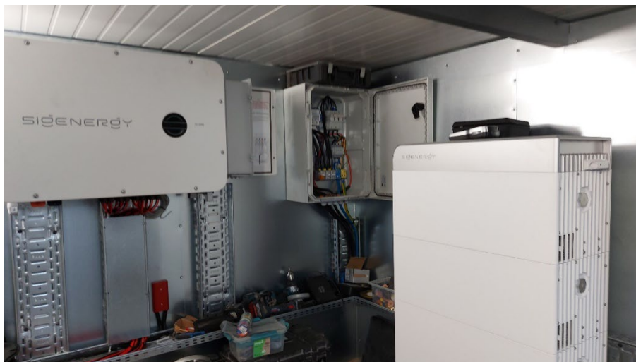
Fot. Widok magazynu energii
