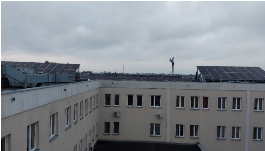
Fot. Widok paneli fotowoltaicznych na dachu.
